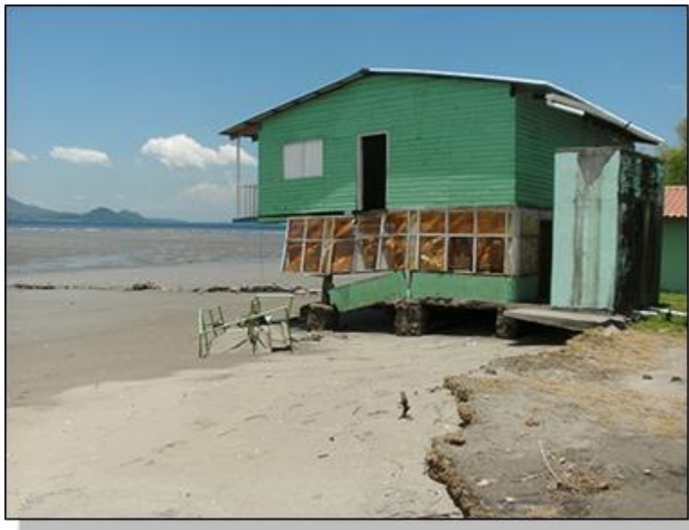
Figura 43. El centro de la tortuga de Punta Ratón, justo antes de que el edificio se derrumbara. El estado del edificio era inhabitable para la temporada 2012, mientras que la pérdida del centro y de la zona del criadero causado divisiones entre el Comité y la comunidad.
